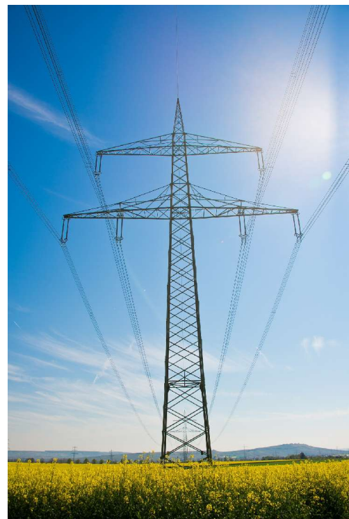
Statt den Strom dort zu erzeugen, wo er gebraucht wird, werden Überlandleitungen gebaut. [1]
